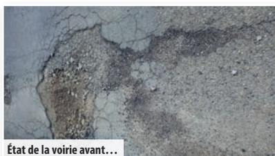
État de la voirie avant...
