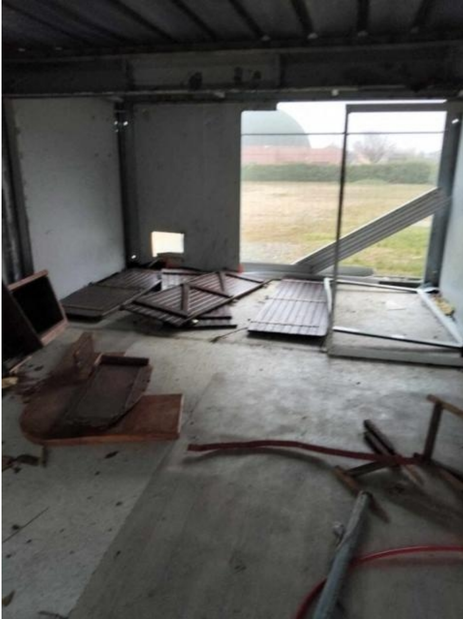
Ce jeudi 6 février 2025, le club de la Patriote rugby de Bonnétable (Sarthe), a retrouvé son club house, en cours de travaux, totalement vandalisé.
